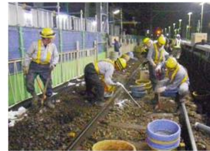
線路上からの薬液注入状況 (終電後の限られた時間での施工)
