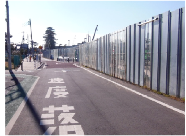
仮囲い(交差点の安全、防犯を考慮し部分的に透明板を設置)
